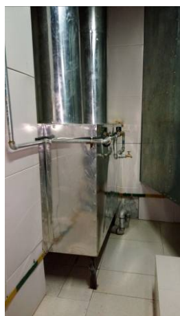
图 6.2-5 备用发电机尾气处理装置
