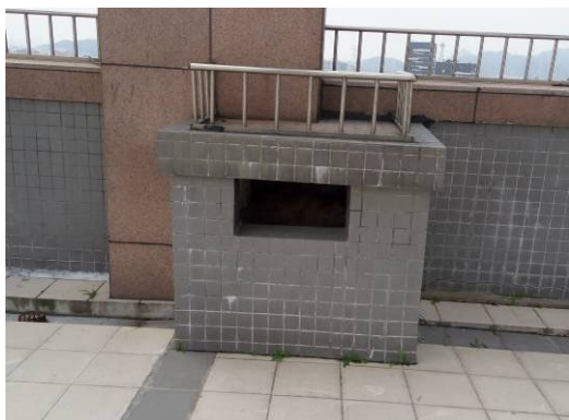
图 6.2-7 备用发电机废气排放口
