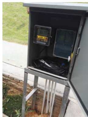
图 6.2-10 废水排放口在线监测装置
