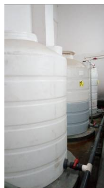
图 7.2-6 废液收集储罐
