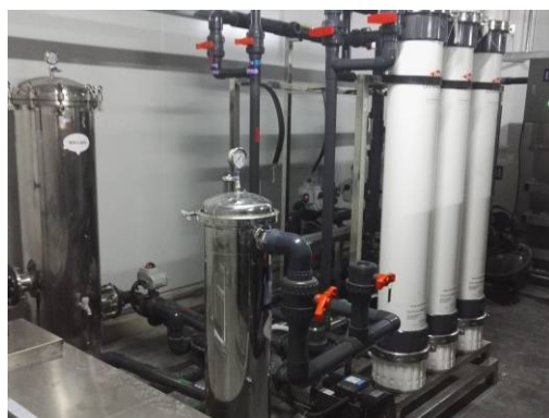
图 6.2-11 切割废水回用处理装置
