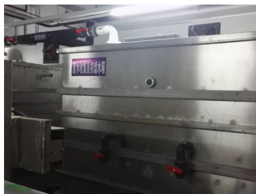
图 6.2-12 切割废水回用处理装置
