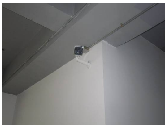
图 7.2-11 实时视频监控
